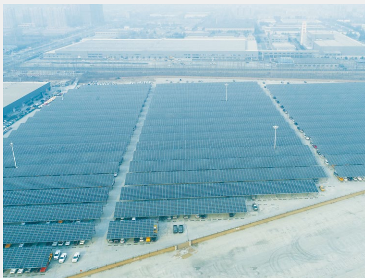
郑州日产中牟工厂光伏项目
